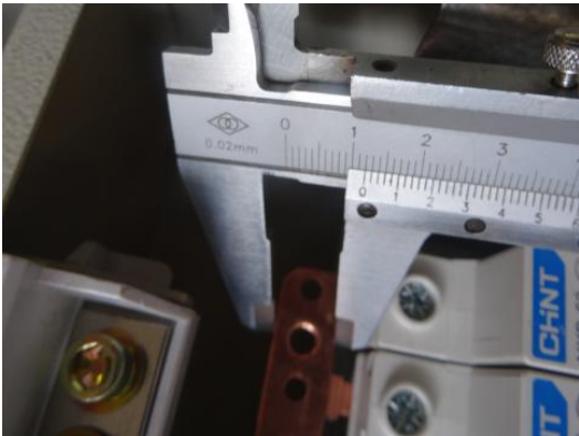
主母排宽度照片
