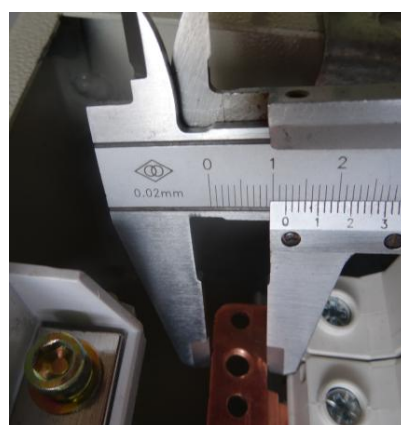
主母排宽度照片
