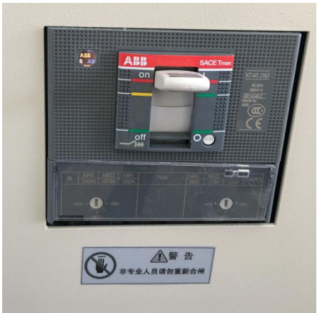
非专业人员警告标识照片
